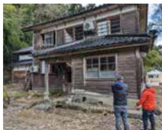
農家民宿群「春蘭の里」（能登町）の再開に向け、建築士が同行して修繕について助言 R6.2月
